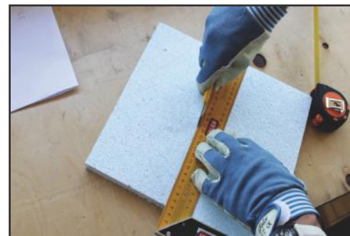
Tagliare a misura i pannelli 1 e 2, e ricavare l'incavo per il supporto
